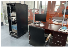
名称：测井井群系统 型号：UPC测井系统7.2米×2.2米×2.5米 放置地点：唐岛湾校区特种实验楼D123-D125
